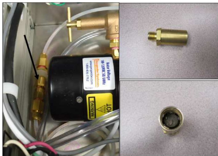
Figure 7.2: Localisation du filtre en ligne dans le boîtier HPT (K6303) et exemple d'agglomérat de particules dans le filtre
